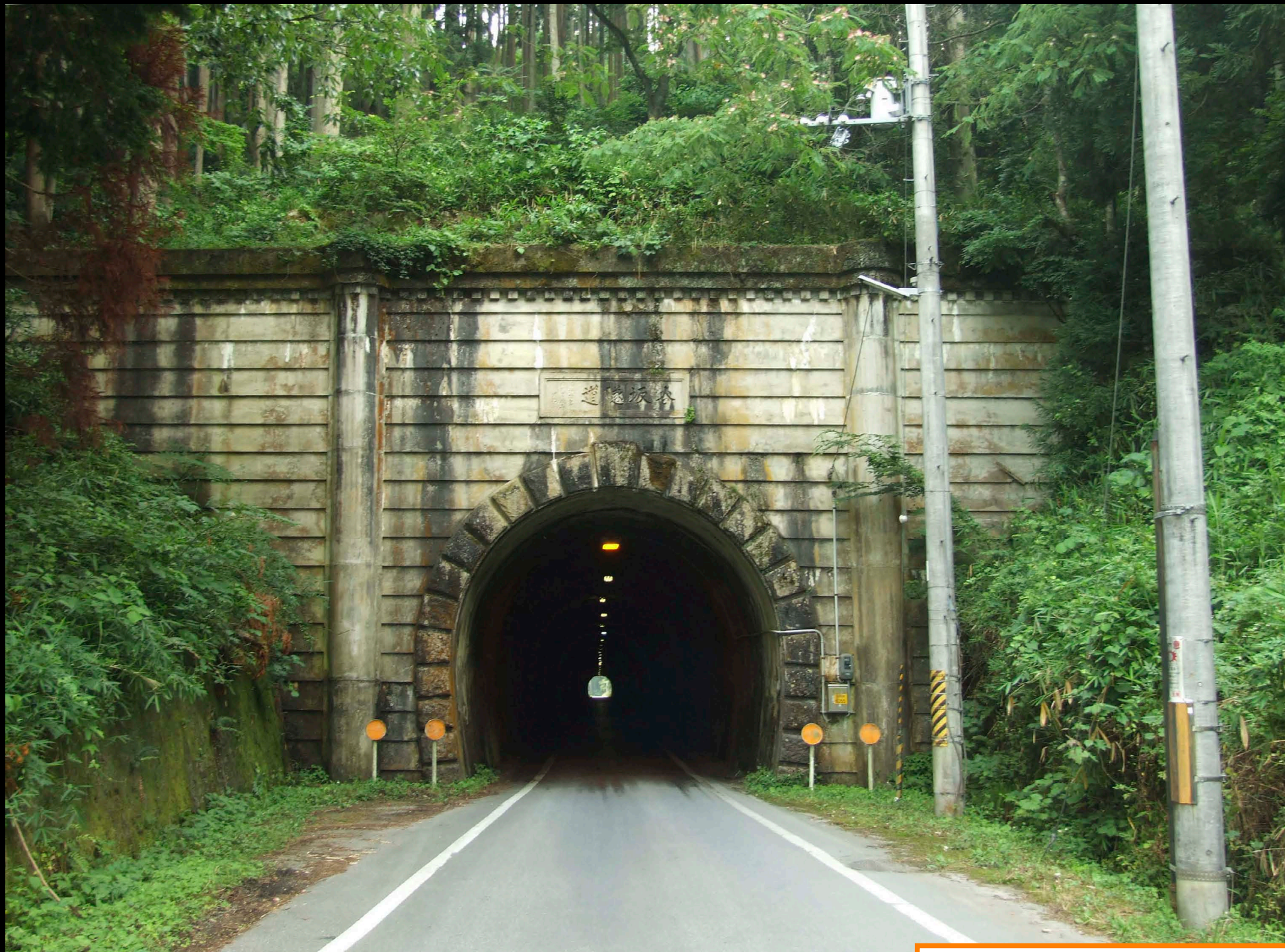
谷坂隧道 排水系統
